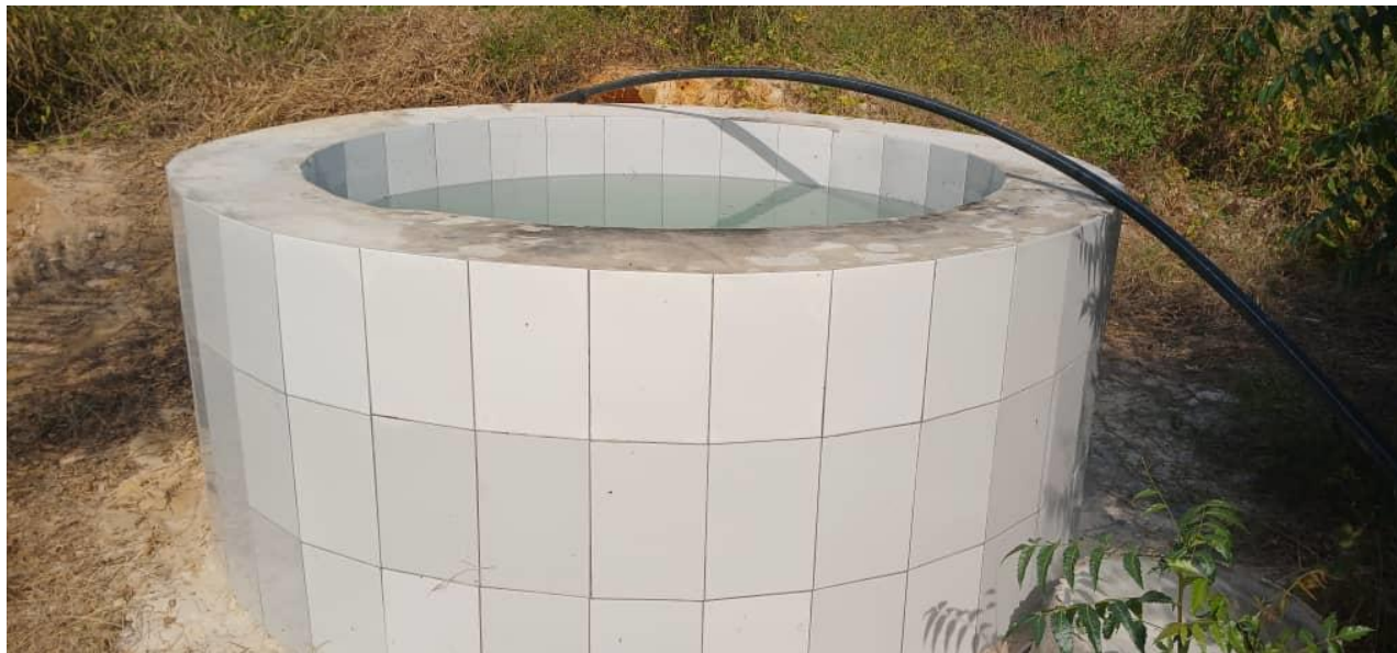
RESERVOIR D'EAU DE PLUIE-10.000m 3
